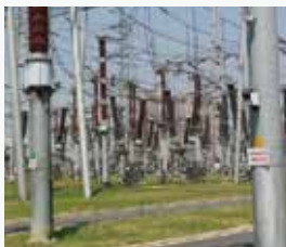
变电站高压区域多， 有线改造风险高
