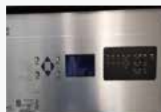
DTU (开关设备监测 + 控制)
