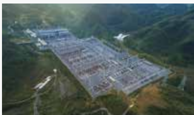
110KV 变电站 巡检点位 >1000
