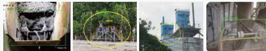
下料口堵塞 人员不安全行为监测 冒灰污染检测 翻斗阀状态识别
