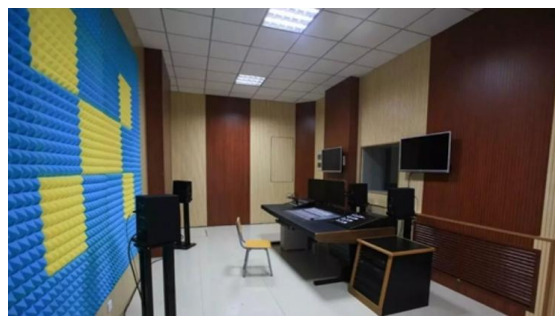
音乐系：走廊内安装部分烟感、教室、音乐厅内均未安装
