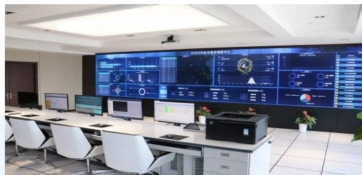
烧成远控中心
