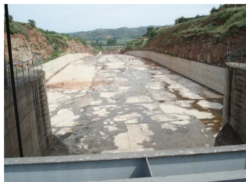
水库溢洪道视频监视
