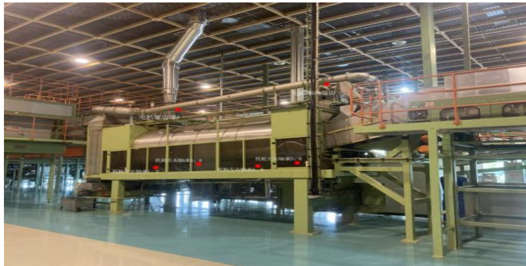
松散回潮机安装点位
