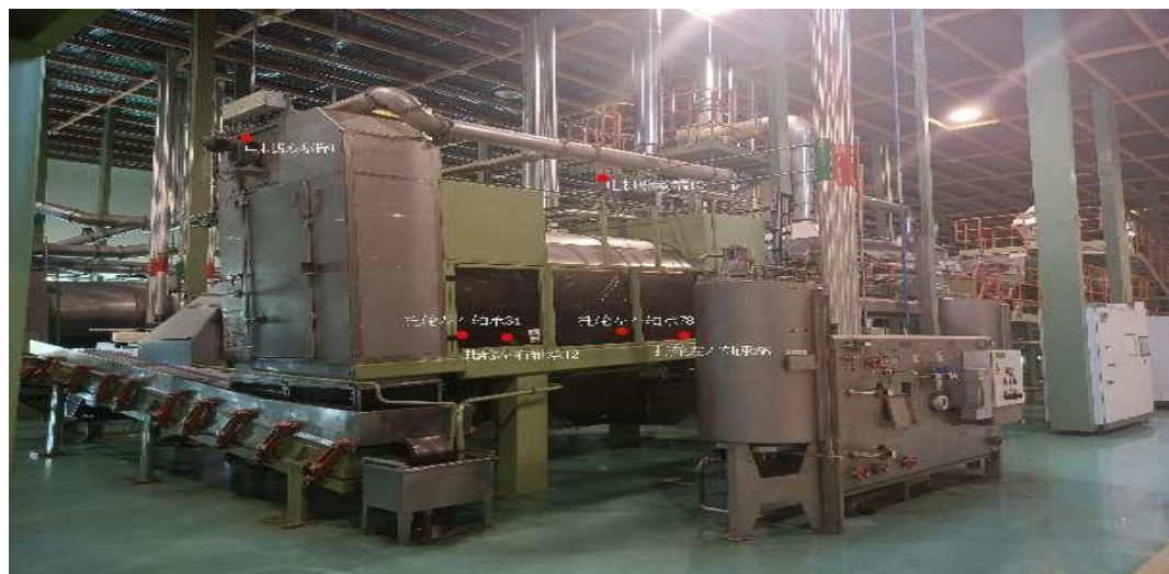
二次加料机安装点位
