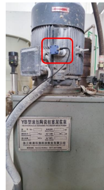
泥浆泵安装点位
