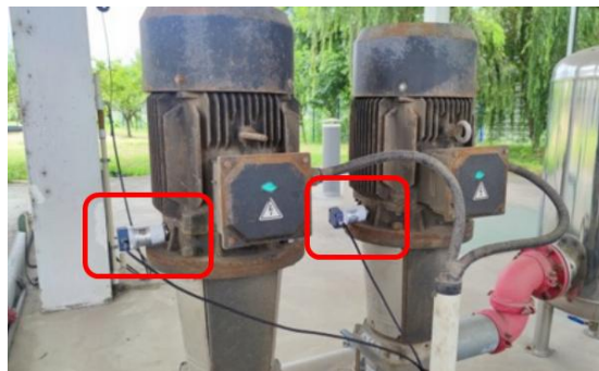
中水泵安装点位
