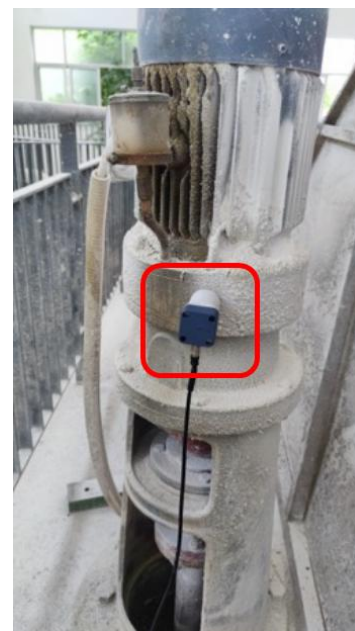
污泥泵安装点位
