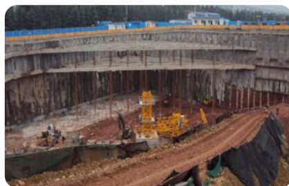
危大工程缺乏有效管理
