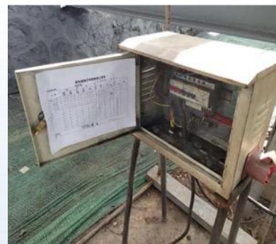
安全用电检查
