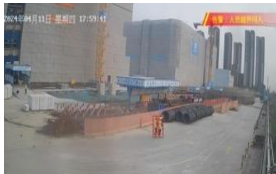
区域人员入侵检测
