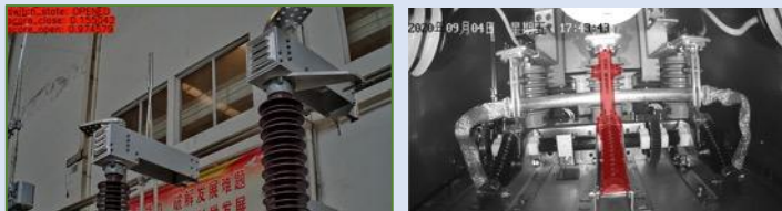
升压站刀闸开关柜识别
